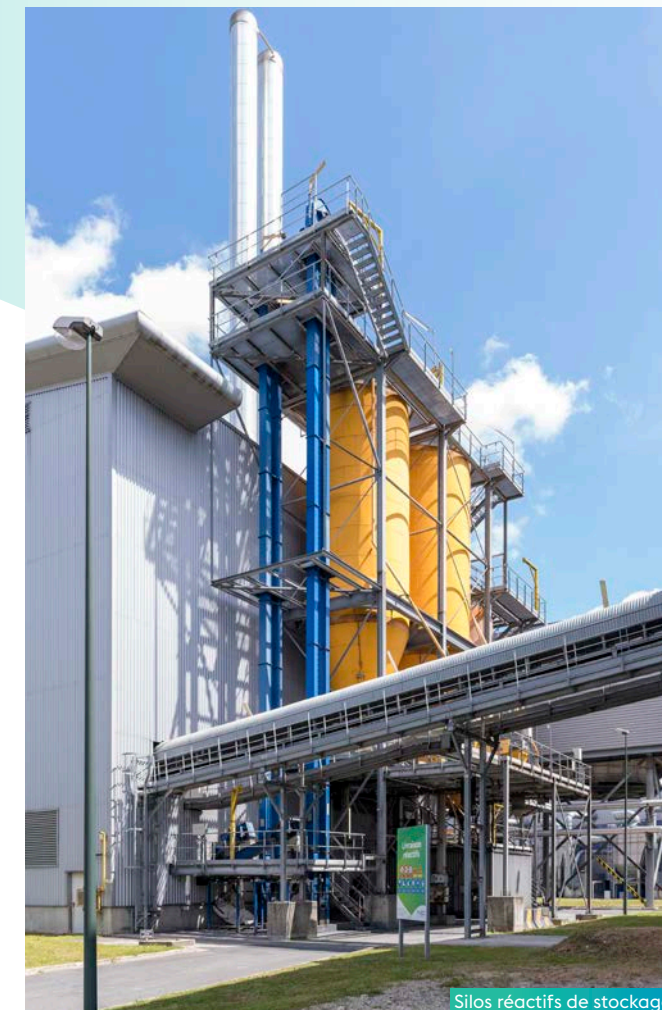
Silos réactifs de stockage
